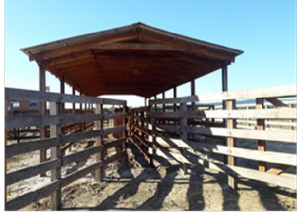
CONSTRUCCION DEL CENTRO DE CONFINAMIENTO DE GANADO BOVINO REALIZADO POR EL IPDSA-PDSGGB
